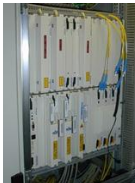
Figura 10. Equipos de transmisión entre centrales.
