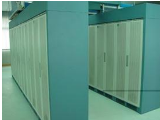
Figura 9. Equipos de conmutación digital.
