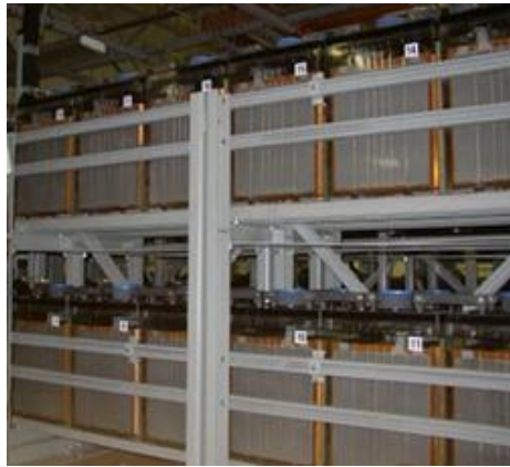
Figura 11. Baterías en flotación.
